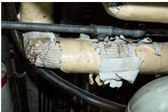
Figuur 58: Voorbeeld van thermische leidingsisolatie in gips
