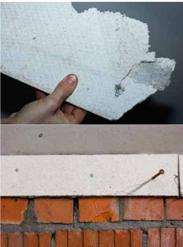
Figuur 54: Platen type "Pical" (boven) en type "Promatect" (onder) vertonen sterke gelijkenissen en zijn allebei te beschouwen als asbestverdacht indien geproduceerd vóór 2001
