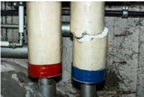
Figuur 57: Voorbeeld van thermische leidingsisolatie in gips
