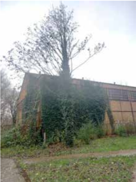
Figuur 40: Voorbeeld van overwoekerende vegetatie aan gevels
