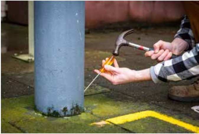
Figuur 65: Voorbeeld van een zorgvuldige monstername van een steunpaal in vezelcement met fijne platte schroevendraaier
