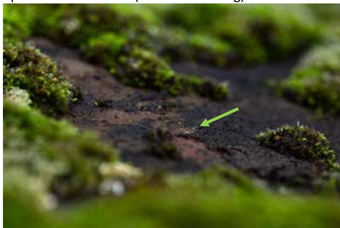
Figuur 45: Voorbeeld van vrijkomende chrysotielvezelbundels door degradatie (mos) van leien in vezelcement
