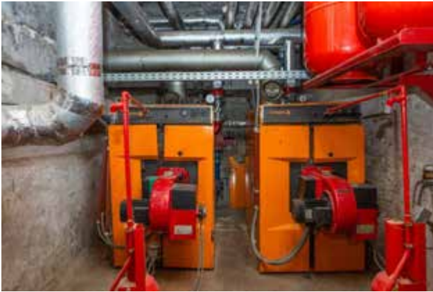
Figuur 23: Voorbeeld van een stooklokaal met stookketels
