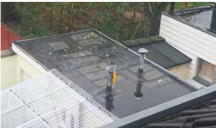
Figuur 37: Voorbeeld van een plat dak met roofing, gezien vanuit een dakvenster
