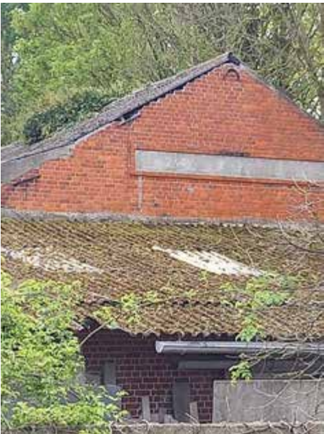
Figuur 49: Voorbeeld van verweerde golfplaten in vezelcement
