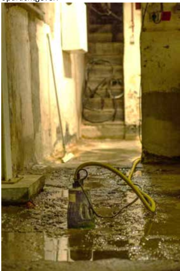
Figuur 39: Voorbeeld van een opgeheven tijdelijke onderzoeksbeperking: water in kelder weggepompt met dompelpomp
