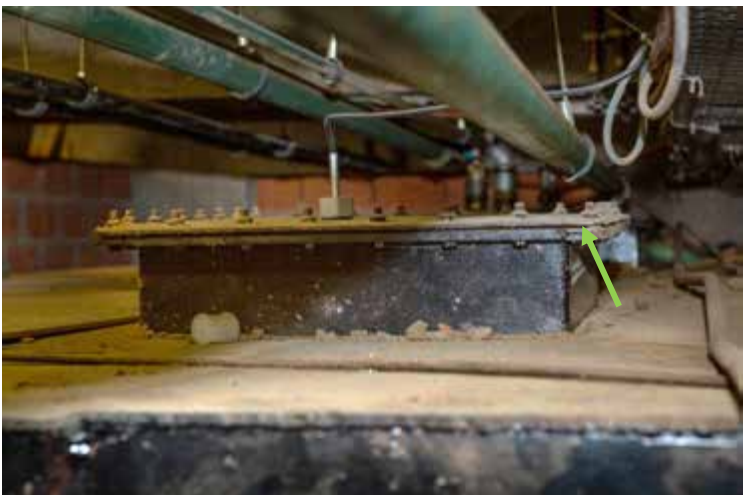
Figuur 51: Voorbeeld van een mangatdeksel van een stookolietank, met mogelijke dichting type "Klingerit"
