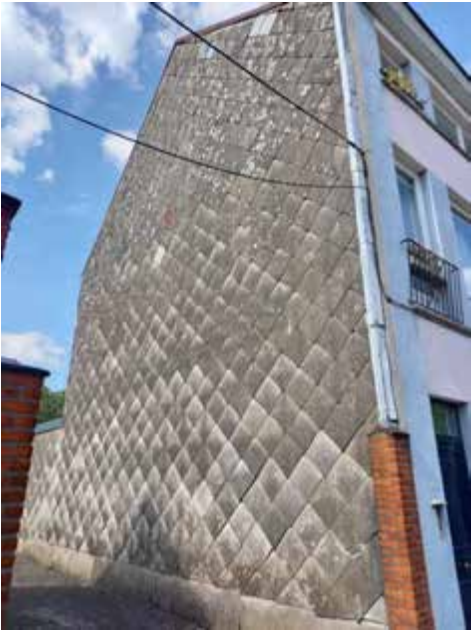
Figuur 48: Voorbeeld van verweerde gevelleien in vezelcement
